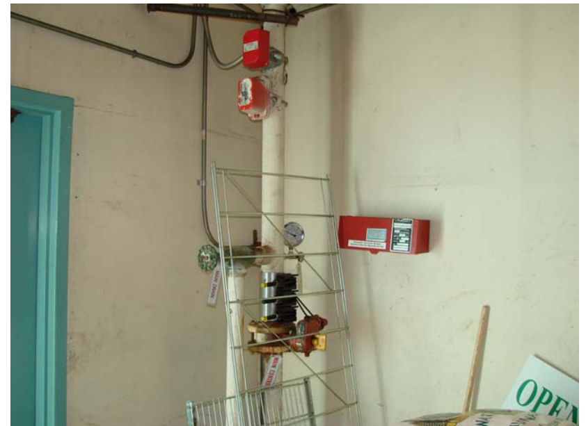
029 P_E: Fire sprinkler riser.
